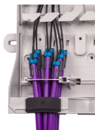
Ukončení mikrotrubiček vnitř rozvaděče
